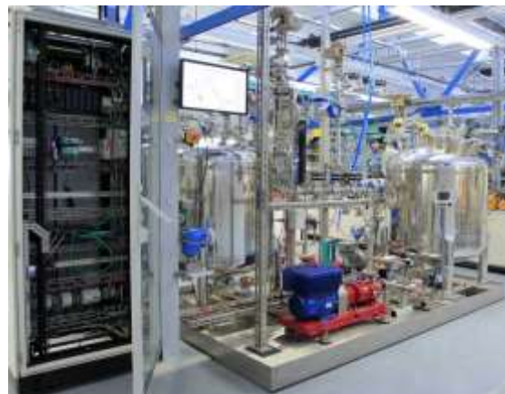
Die Testanlage von Bilfinger Maintenance am Standort Frankfurt-Höchst. Quelle: Bilfinger
