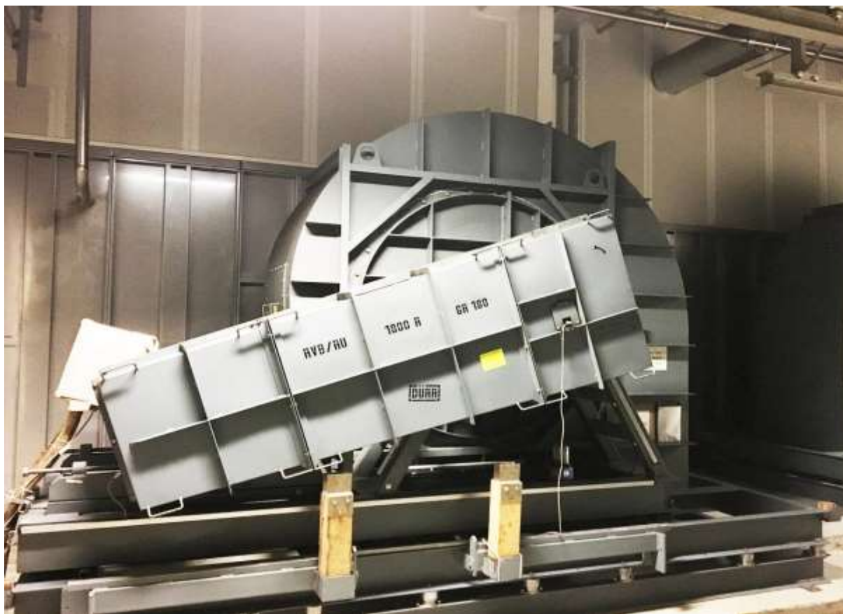
Lüfter in der Lackierstraße des BMW-Werks in Regensburg.
