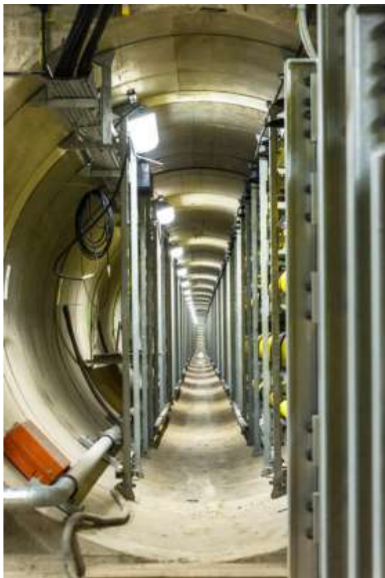
Einblick in den neuen Versorgungstunnel. Quelle: TECTRION
